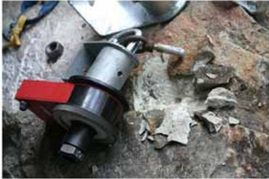
コン破壊の状況と抜けたアンカー
