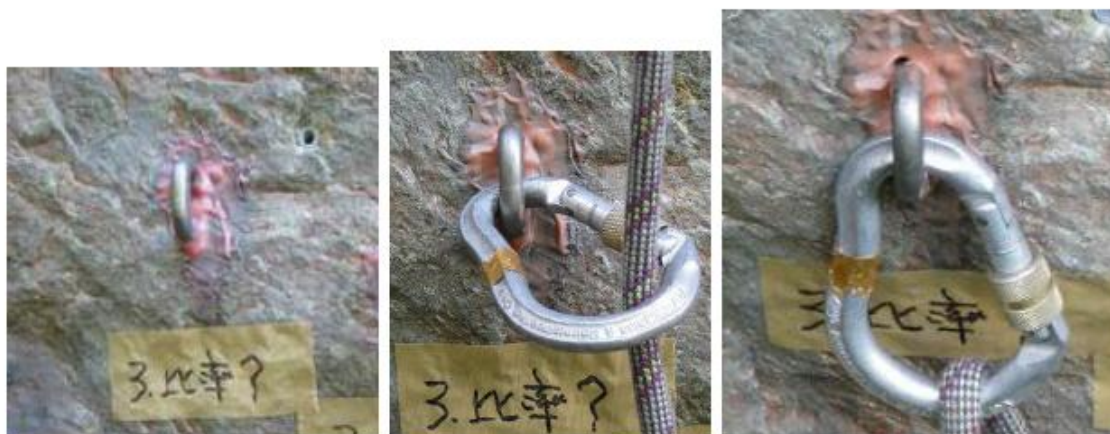
(a) 設置後の状態。
