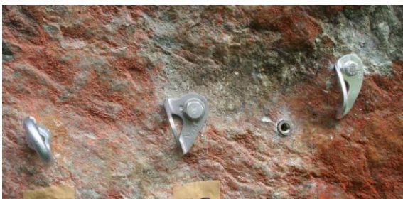
大ハング中央部に設置した各種のアンカー類。左から直径12mmのオールアンカー、直径10mmのカットアンカー、Petzl P12 アルミハンガーのアンカー。左端のオールアンカーは、あとの写真で示すように、ボルトの根元から折れてしまった。
